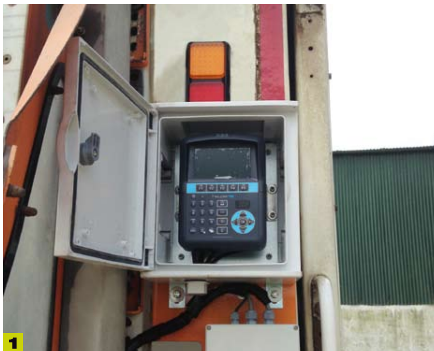
1 helperXE - terminal in incinta exteriora
